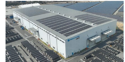
タキロンシーアイシビル(株)土浦工場設置の太陽光パネル
